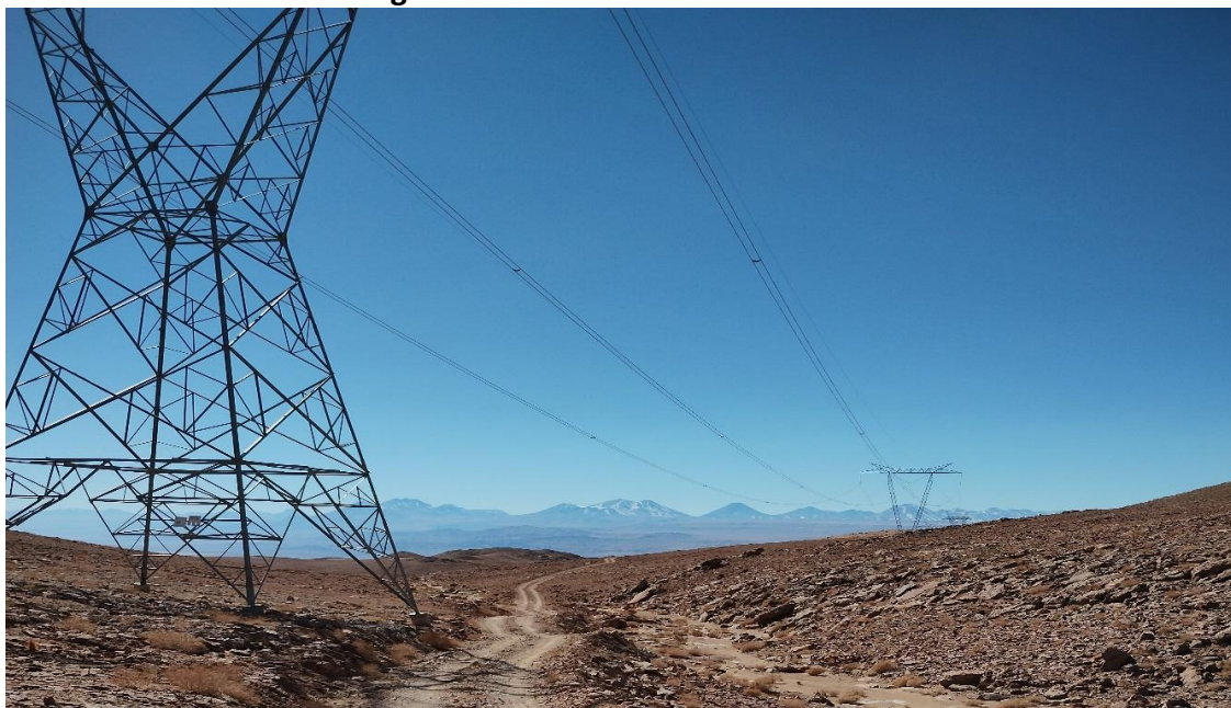
Fotografía 9: Torres de cableado eléctrico
