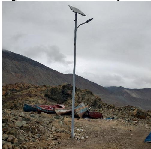
Fotografía 19: Poste de luz con panel solar
