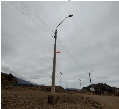
Fotografía 18: Poste del sistema público de energía
