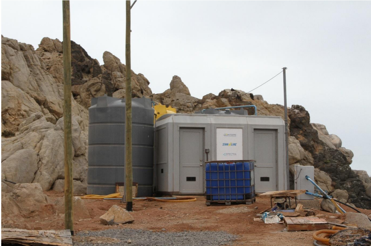
Fotografía 6: Planta desaladora de agua en Caleta Cifuncho.
